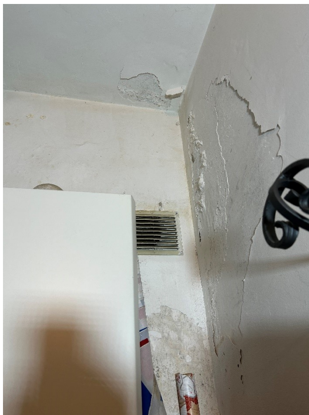
Foto n. 14 – Infiltrazioni d’acqua nelle pareti della dispensa in corrisp. della canna fumaria della caldaia
