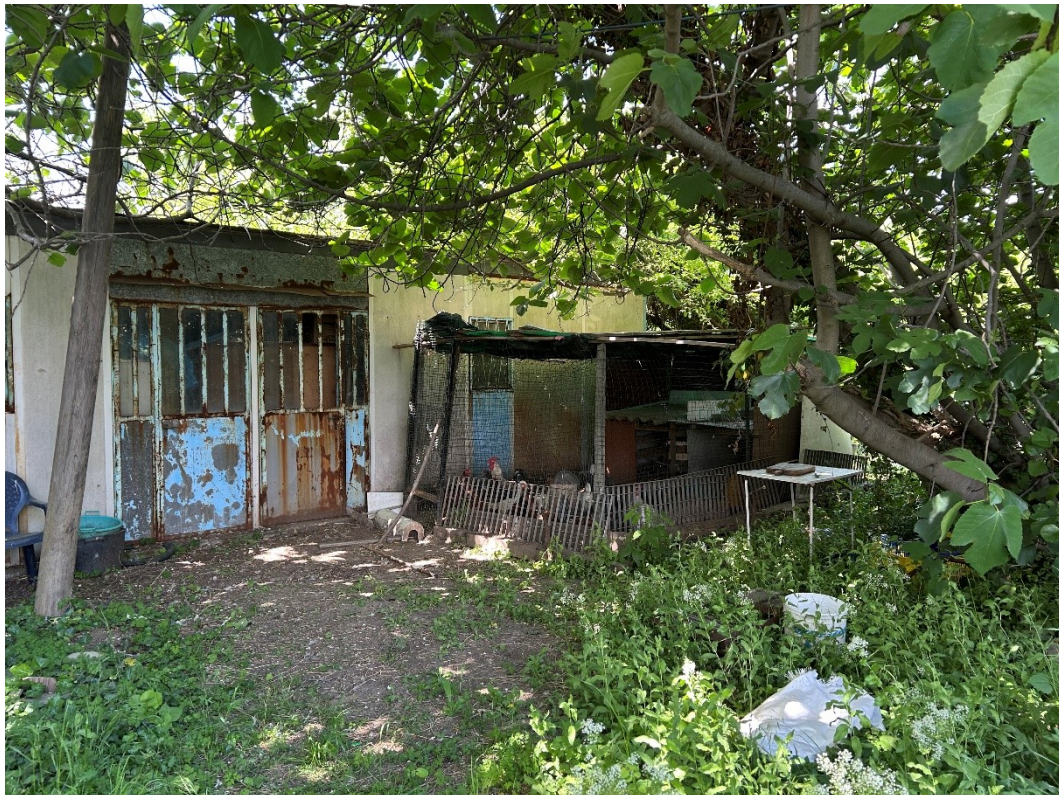
Foto n. 23 – Manufatti in precarie condizioni insistenti sul mappale 327
