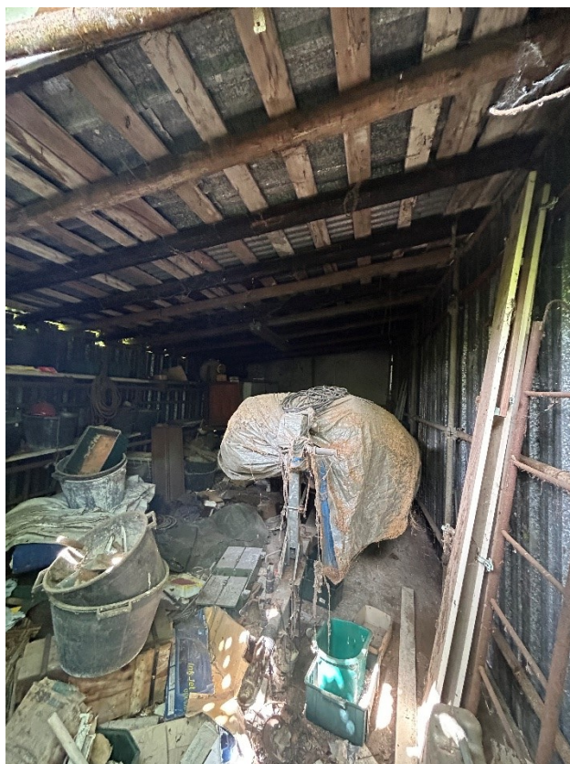
Foto n. 24 – Manufatti in precarie condizioni insistenti sul mappale 327
