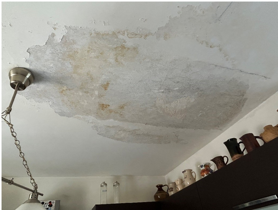
Foto n. 13 – Infiltrazioni d'acqua nel soffitto della cucina
