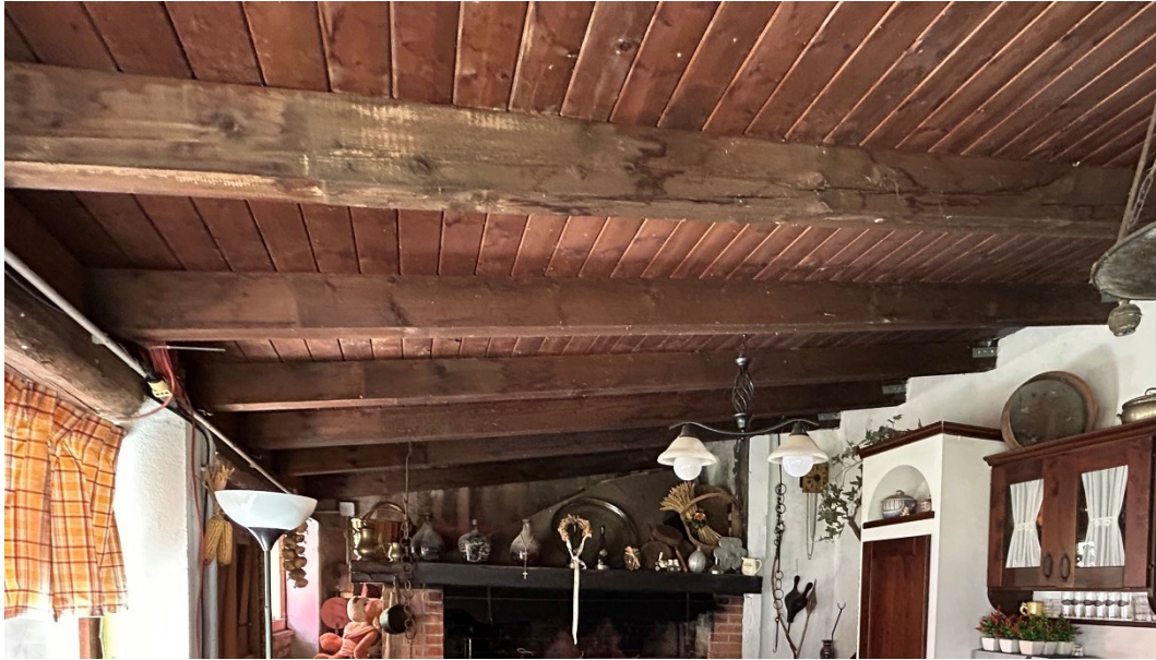
Foto n. 16 – Segni di infiltrazioni d'acqua dal tetto del portico
